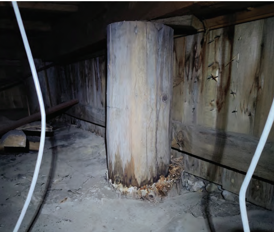
Sviktende fundamentering er en stor trussel for Longyearbyen bygg. Pelar råtner i overgang mellom jord og luft. Sidebelastning fra fyllmasser inn til vegger kan føre til brudd.
